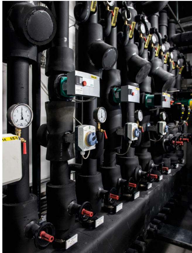
👉 Cold water distribution regulating the temperature in the laboratories. Kaltwasserverteilung zum Temperieren der Labore.
